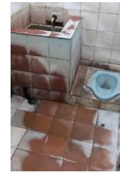
Gambar 1.6 Toilet di Pasar Johar yang tidak terawat Sumber: dokumentasi pribadi
