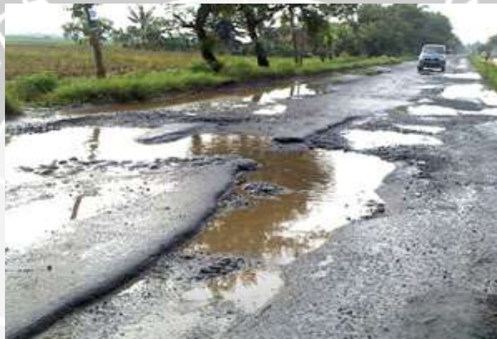
Gambar 1.2 Kerusakan Pada Jalan Pantura
