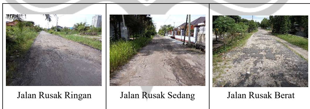
Gambar 5.4 Tipe kerusakan jalan lingkungan
