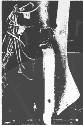
Gambar 2. 2 Kerusakan Antara Sambungan Pipa Baja dan Plat Gusset (Martinez-Saucedo dan Packer, 2006)
