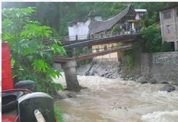
Gambar 1.1. Kondisi Jembatan Tedong Tedong setelah Banjir
