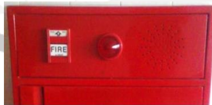
Gambar 6.15 Fire Alarm Sumber : Dokumen Penulis, 2014
