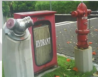
Gambar 6.14 Box Hidran Sumber : Dokumen Penulis, 2014
