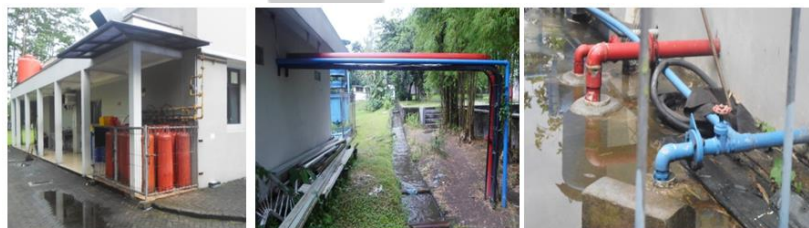
Gambar 6.16 Pasokan Air untuk Proteksi Kebakaran Sumber : (Dokumen Penulis, 2013)
