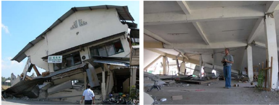
Gambar 11. Kerusakan pada kolom lantai bawah
