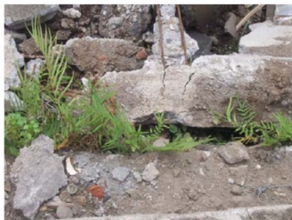
Gambar 2. Tulangan kolom yang tidak diteruskan sampai ke fondasi
