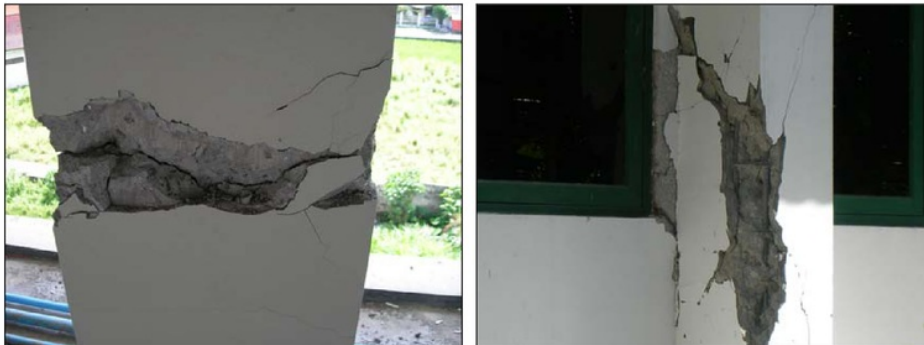
(b) Kolom rusak 2
