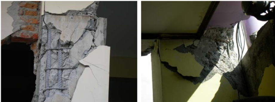
(a) Kolom rusak 1
