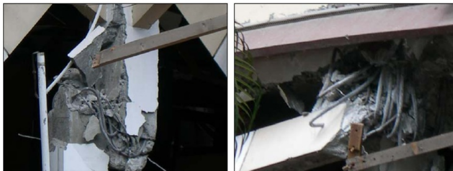
(c) Kerusakan pada kolom gedung STIE Kerjasama
