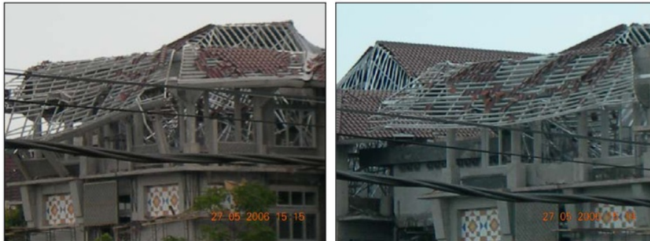
Gambar 14. Gedung UIN yang sedang dibangun rusak parah pada atapnya
