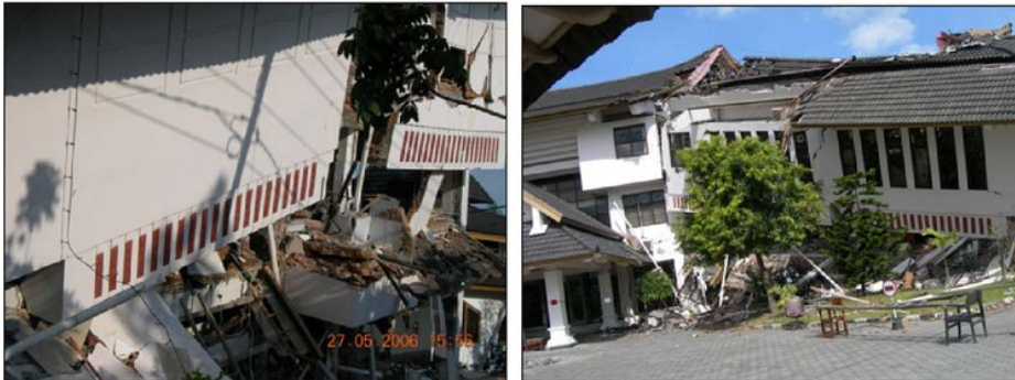
(b) Gedung BPKP runtuh view 3-4
