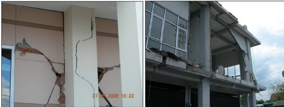
(a) Retak pada tembok Ambarukmo Plaza (b) Dinding jatuh di Seturan Plaza
