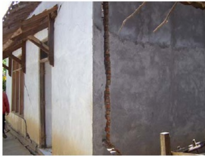
Gambar 4. Tembok yang tidak diikat dengan angkur pada kolom
