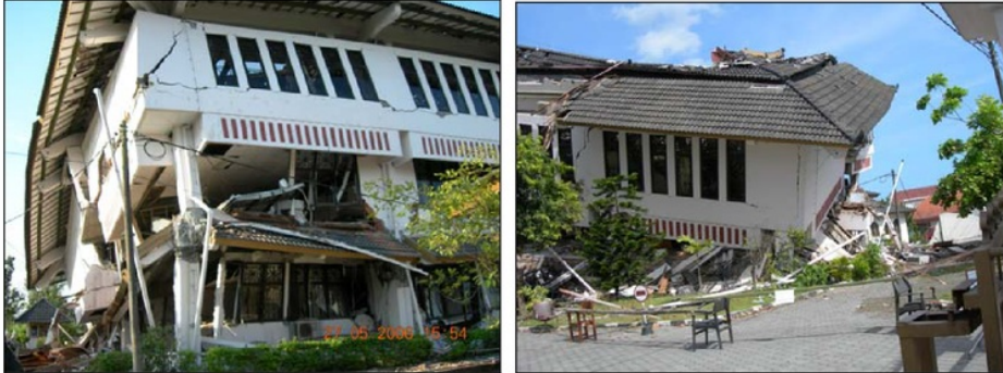
(a) Gedung BPKP runtuh view 1-2
