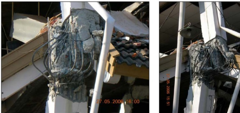
(c). Kolom gedung BPKP yang runtuh
