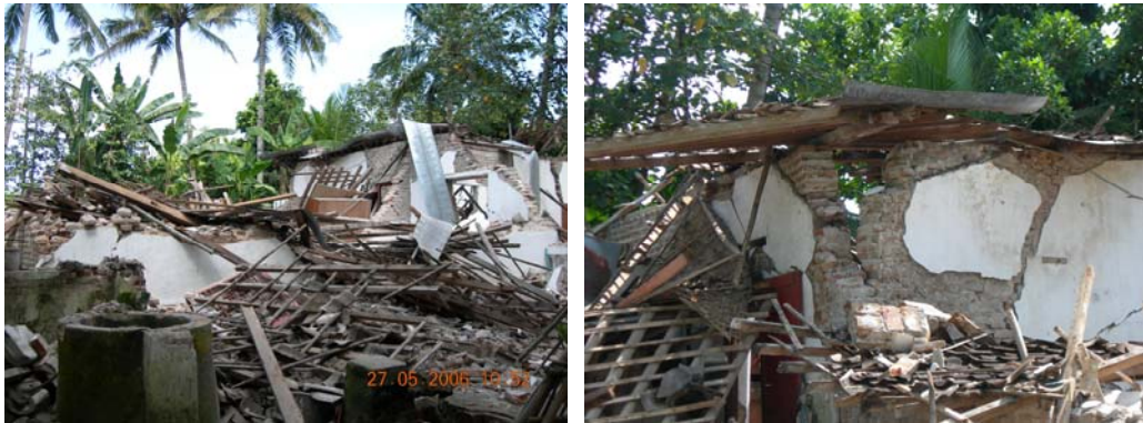
Gambar 1. Rumah pasangan bata satu batu dengan spesi kapur yang roboh di daerah Bambanglipura, Bantul
