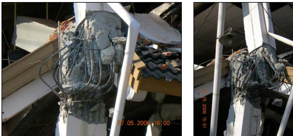
(c). Kolom gedung BPKP yang runtuh
