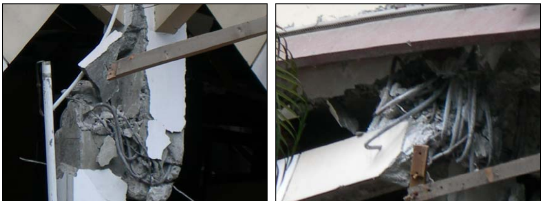
(c) Kerusakan pada kolom gedung STIE Kerjasama
