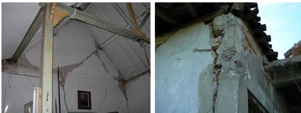
(b) Gunungan dan tembok retak
