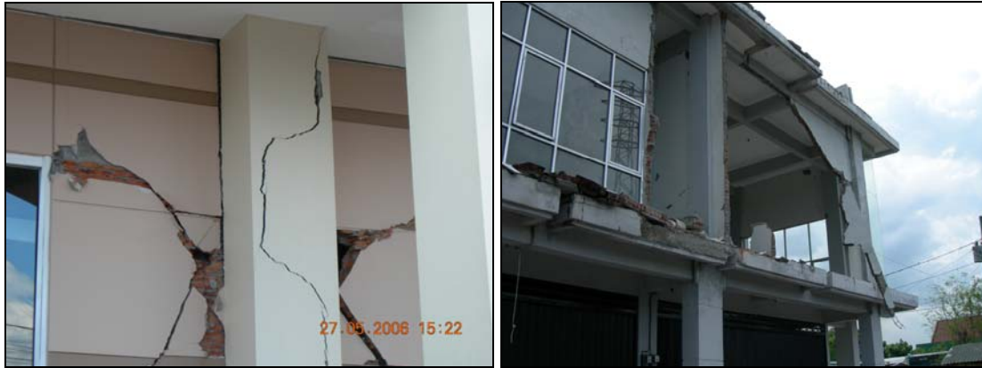
(a) Retak pada tembok Ambarukmo Plaza
