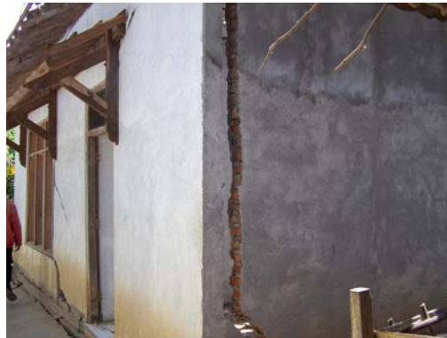
Gambar 4. Tembok yang tidak diikatkan dengan angkur pada kolom
