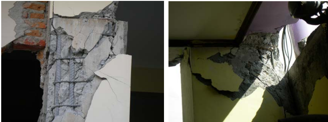
(a) Kolom rusak 1
