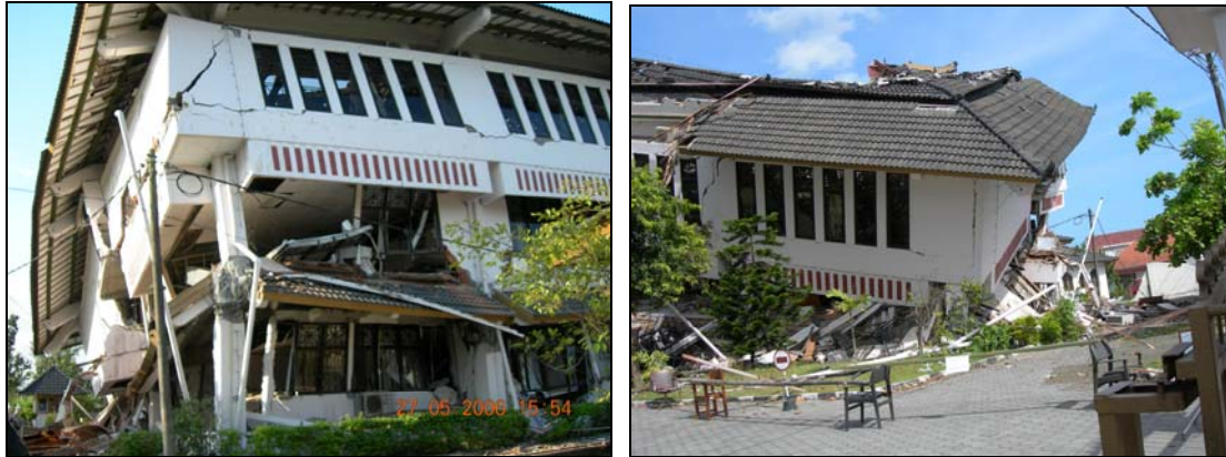
(a) Gedung BPKP runtuh view 1-2
