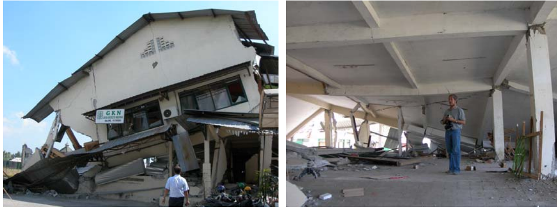
Gambar 11. Kerusakan pada kolom lantai bawah
