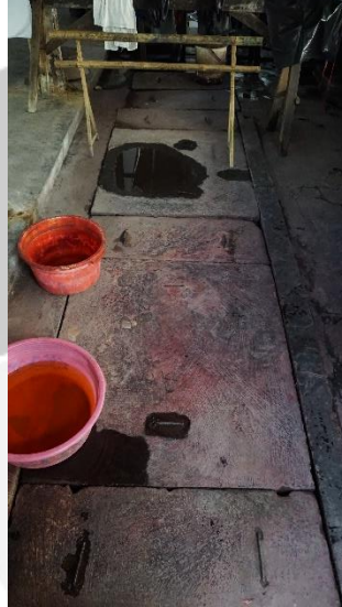
Gambar 23. Bak Penampungan Awal Instalasi Pengolahan Limbah
