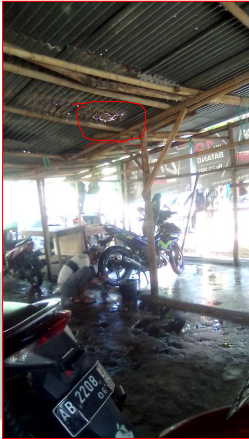
Terdapat lubang pada atap
