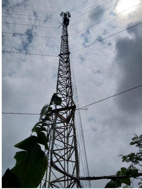
Gambar 2.3.3 Tower BTS untuk daerah Jalan Parangtritis
