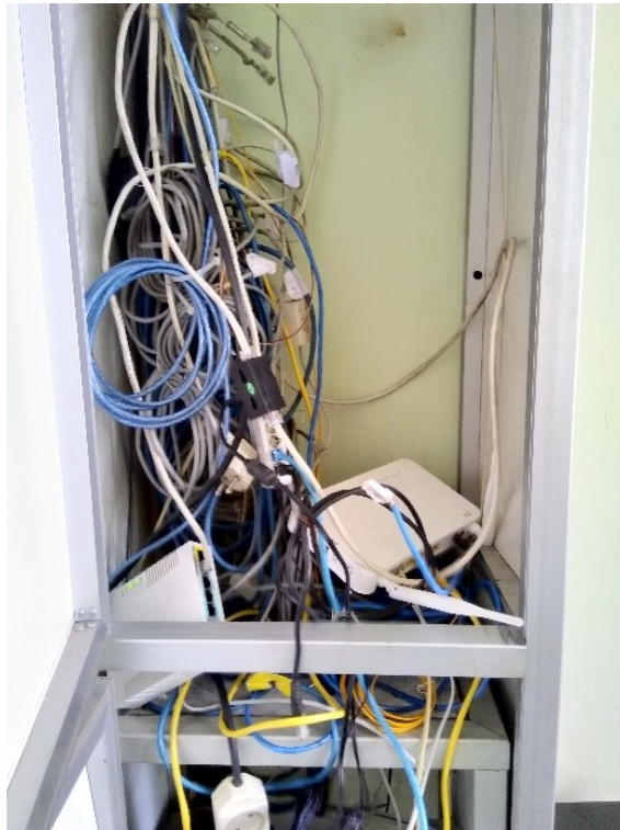
Gambar 2.3.5 Ruang server untuk klien Seta Travel
