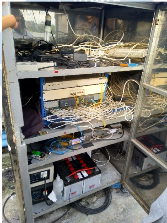
Gambar 2.3.14 Maintenance pada BTS Universitas Achmad Yani
