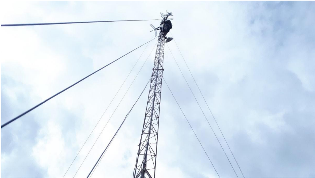
Gambar 2.3.4. Instalasi perangkat Access Point Outdoor yang dipasang di tower three angel .
