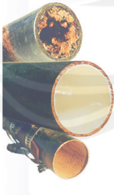
Gambar 2. Terbentuknya koloni mikroorganisme yang menyumbat saluran pada pipa-pipa ( Sumber: Joseph dkk, 2006)
