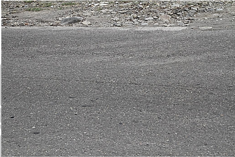
Kerusakan Jalan Akibat Retak Memanjang
