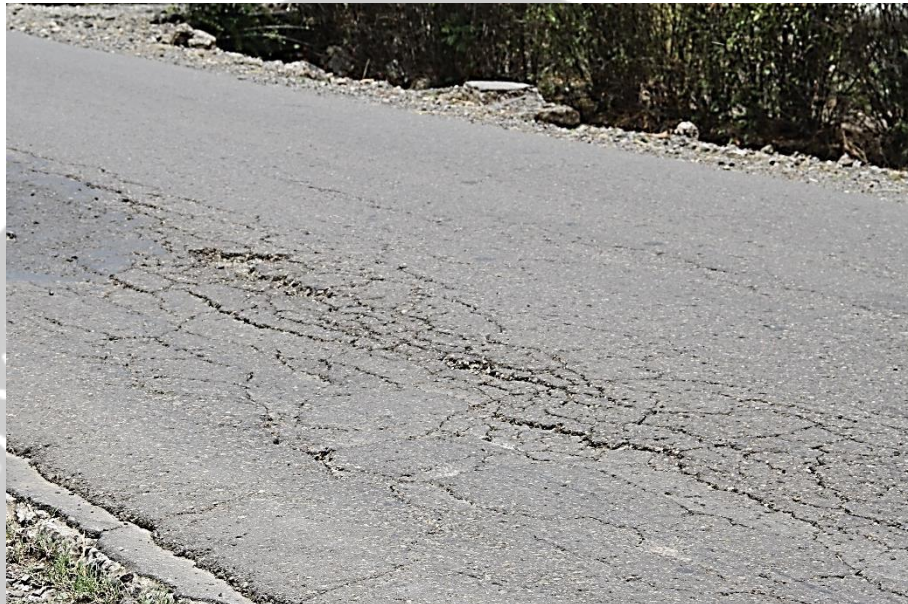
Kerusakan Jalan Akibat Retak Kulit Buaya
