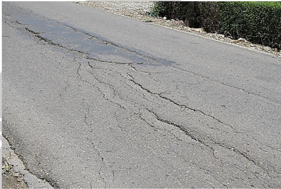
Kerusakan Jalan Akibat Retak Berkelok-kelok
