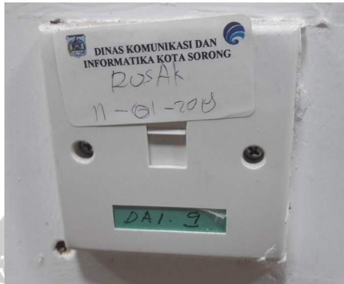
Gambar 2.21 Pelabelan pada port yang status rusak
