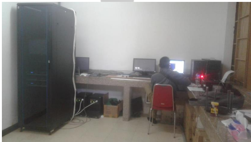
Gambar 2.1 Ruang Server Diskominfo Kota Sorong
