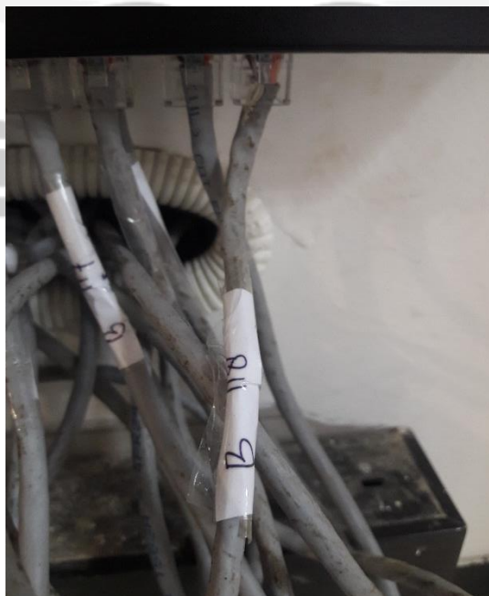
Gambar 2.22 Pelabelan pada konektor kabel LAN yang status baik dan sudah tersambung.
