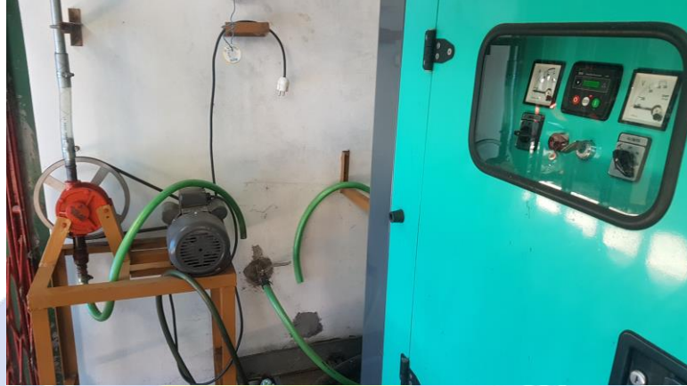
Gambar 2.34 Pompa Diesel dan Generator Set
