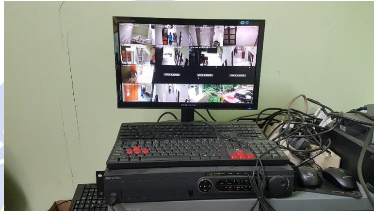
Gambar 2.29 Tempat Pengontrolan CCTV Kantor
