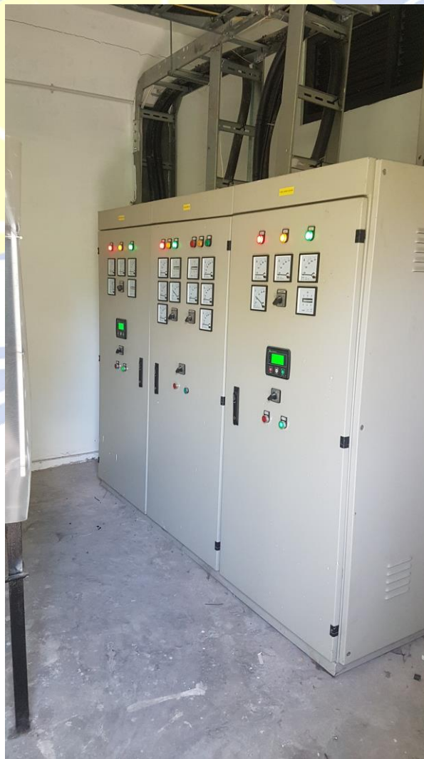
Gambar 2.35 Ruang Penyetingan Generator Set
