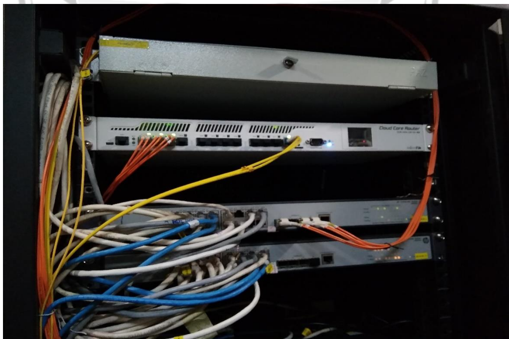
Gambar 2.6 Router dan Switch Gedung A
