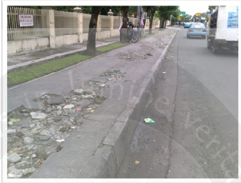
Gambar 1.4. Material Trotoar yang Rusak
