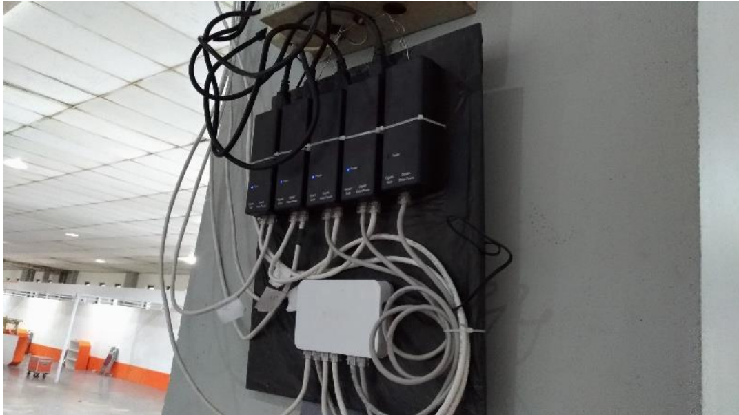
2.3.3 Pemasangan Router dan Acess Point untuk kegiatan LKS di JEC
