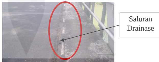
Gambar 2.8. Saluran Drainase ( Jembatan Bunder, Foto diambil tanggal 2 Mei 2010)
