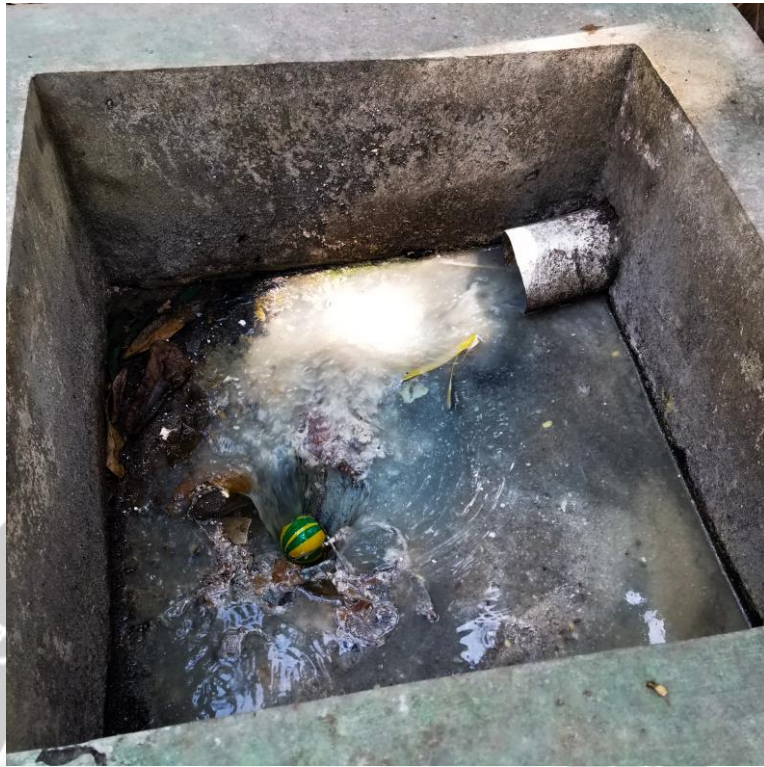
Gambar 9. Saluran pembungan limbah menuju biodigester
