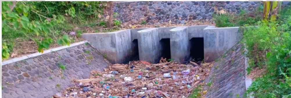
Gambar 1.3. Kondisi Eksisting Pembuangan Akhir Saluran Irigasi Primer Desa Panjangrejo Sumber: Survey Lapangan, 2019
