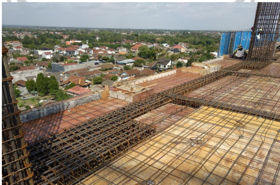
Gambar 1.1 Pelebaran Pada Tumpuan Proyek Yudhistira Tower
