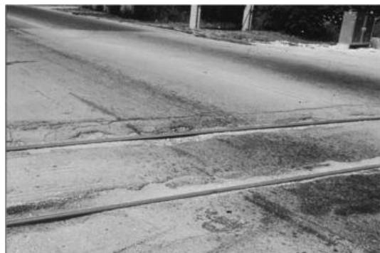
Gambar 2.18. Kerusakan Persilangan Jalan Rel
