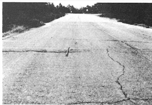
Gambar 2.8. Kerusakan Tonjolan dan Lengkungan
