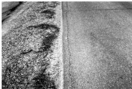
Gambar 2.11. Kerusakan Retak Tepi
