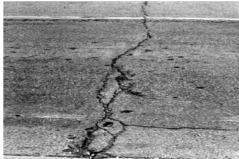
Gambar 2.12. Kerusakan Retak Refleksi Sambungan
