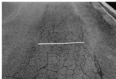
Gambar 2.5. Kerusakan Retak Kulit Buaya
