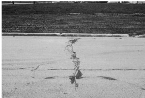
Gambar 2.14. Kerusakan Retak Memanjang/Melintang
