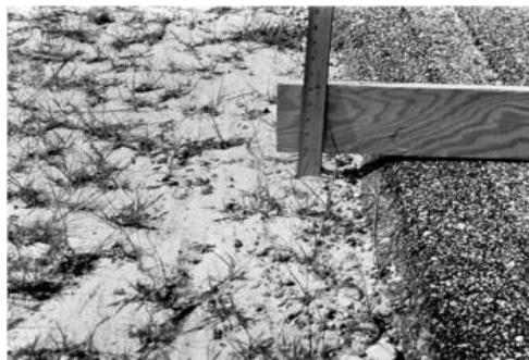
Gambar 2.13. Kerusakan Penurunan Bahu Jalan
