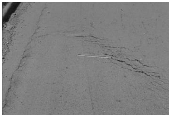
Gambar 2.21. Kerusakan Retak Selip
