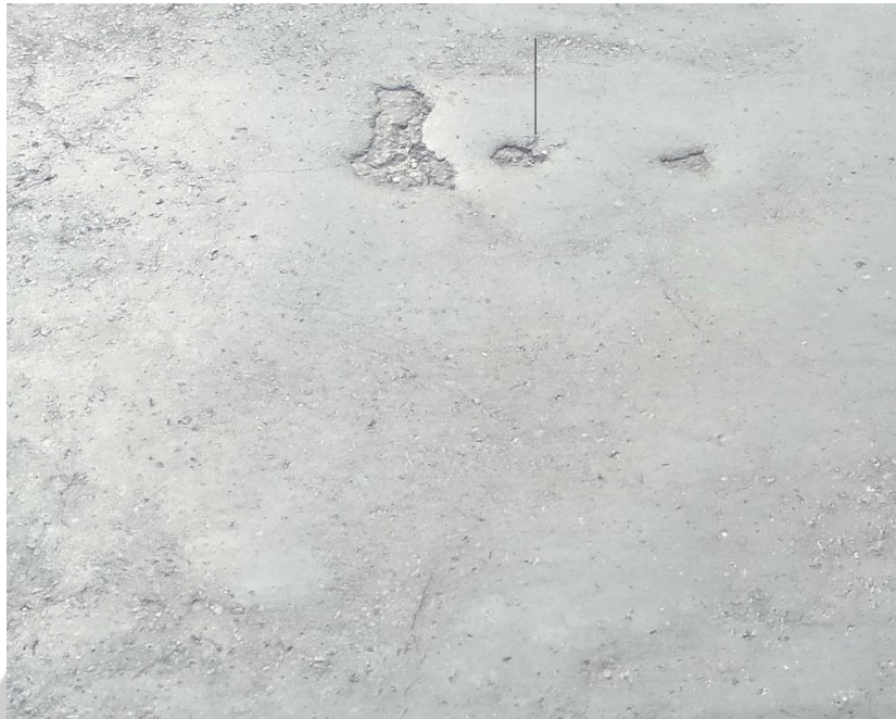
Lampiran C.13 Gambar Kerusakan Pengembangan
