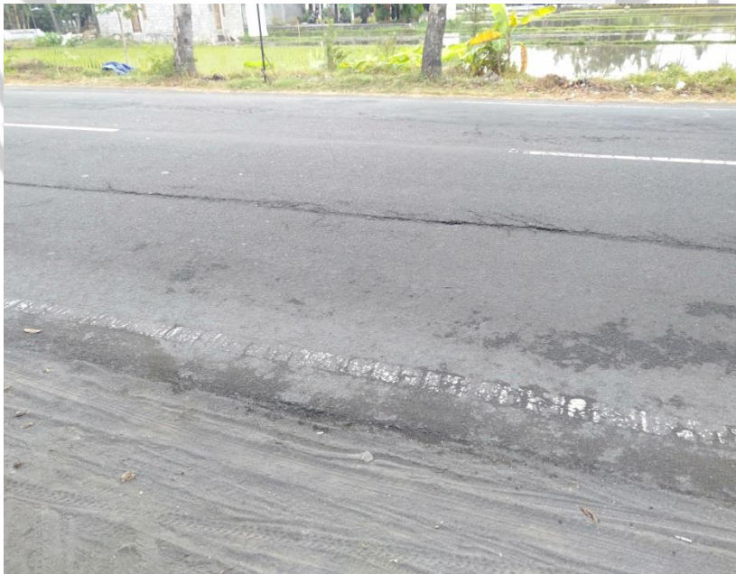
Lampiran C.6 Gambar Kerusakan Retak Memanjang
