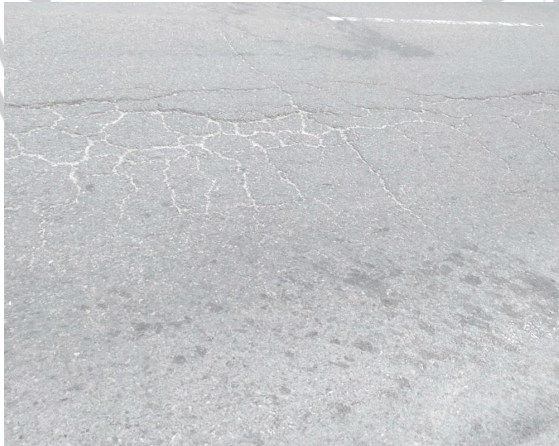
Lampiran C.12 Gambar Kerusakan Retak Selip
