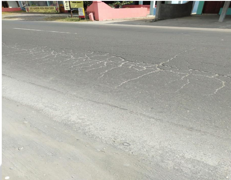
Lampiran C.3 Gambar Kerusakan Retak Blok
