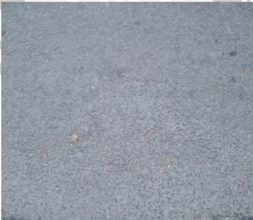
Lampiran C.14 Gambar Kerusakan Pelepasan Butiran
