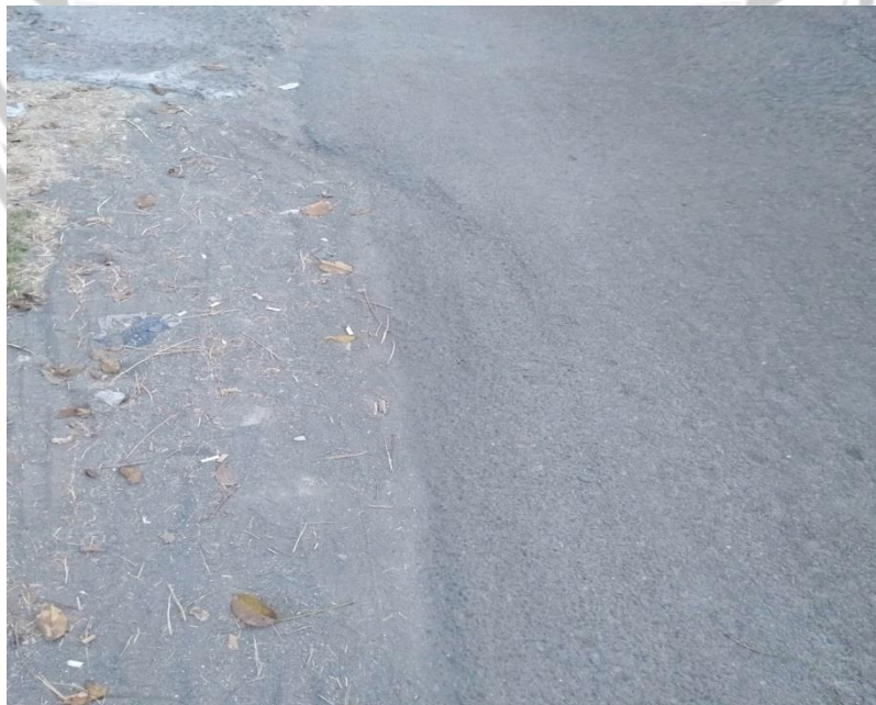
Lampiran C.4 Gambar Kerusakan Amblas
