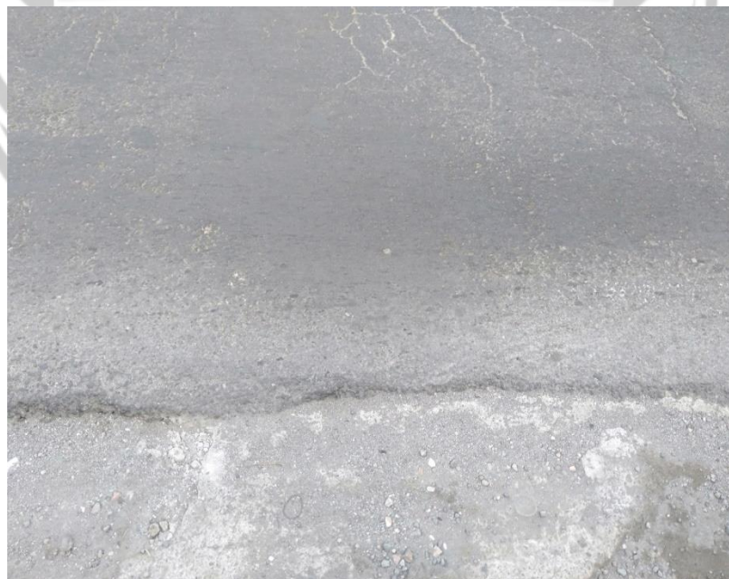
Lampiran C.2 Gambar Kerusakan Kegemukan
