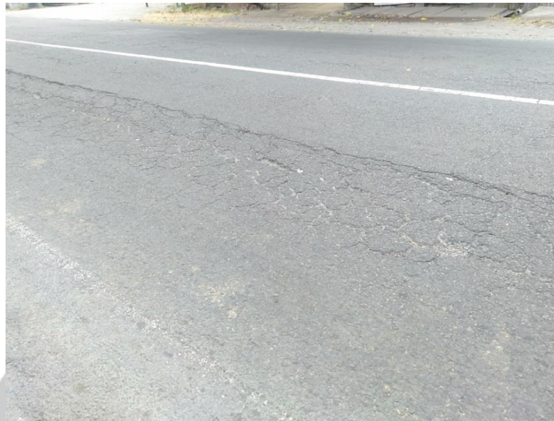
Lampiran C.1 Gambar Kerusakan Retak Kulit Buaya
