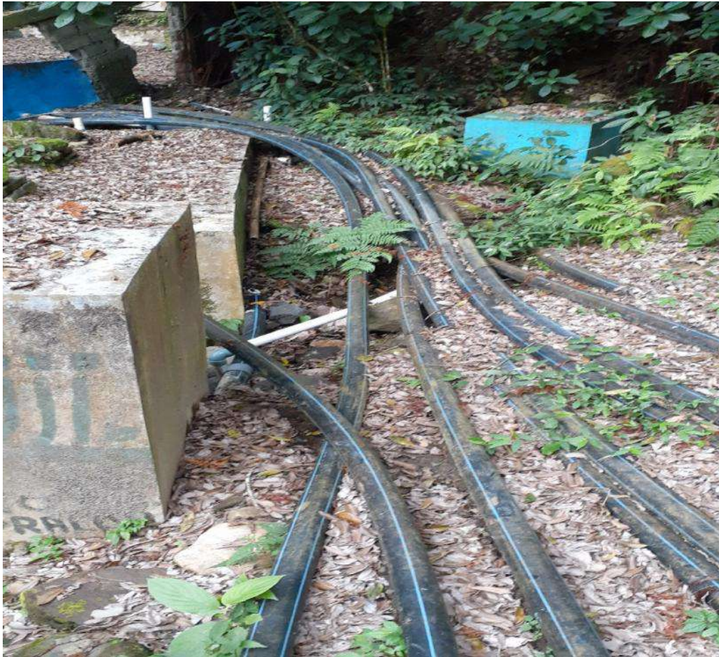
Lampiran 2 Kondisi Pipa Air setelah ada pengelolaan yang baik
