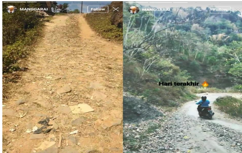
Gambar 13: Kondisi Jalan di daerah Cibai
