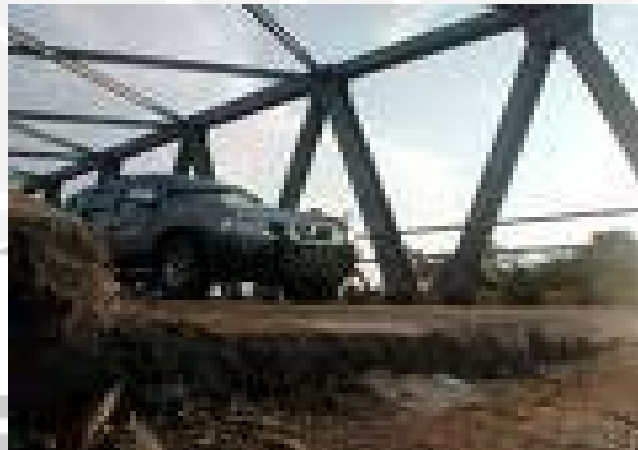
Gambar 2.25. Kerusakan Pada Oprit Jembatan Tol Kapuas
