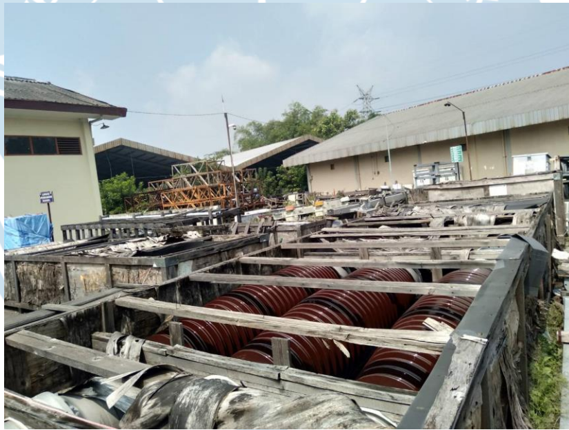
Kemasan Material yang Rusak
