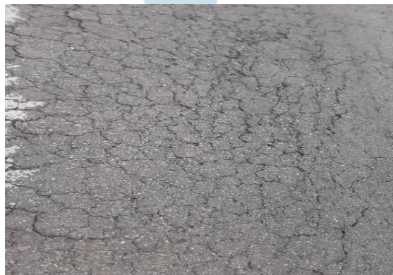
Gambar 3.1 Kerusakan Retak Kulit Buaya
