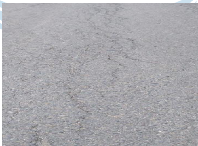
Gambar 3.4 Kerusakan Retak Memanjang/Melintang
