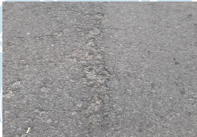
Gambar 3.7 Kerusakan Pelepasan Butiran
