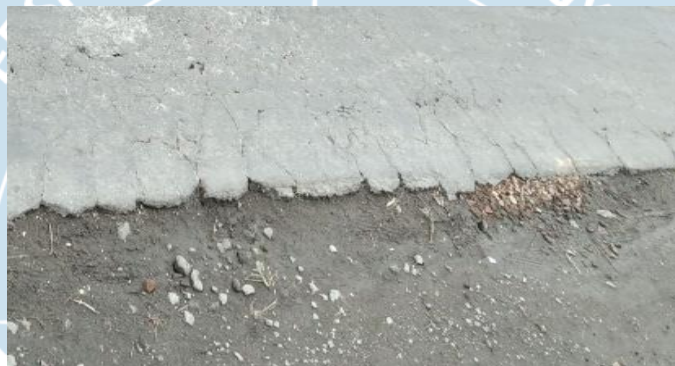
Gambar 3.3 Kerusakan Retak Pinggir
