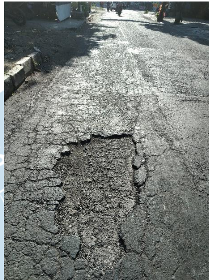
Gambar 1. 1 Kondisi Permukaan Jalan Gito-Gati, Kabupaten Sleman
