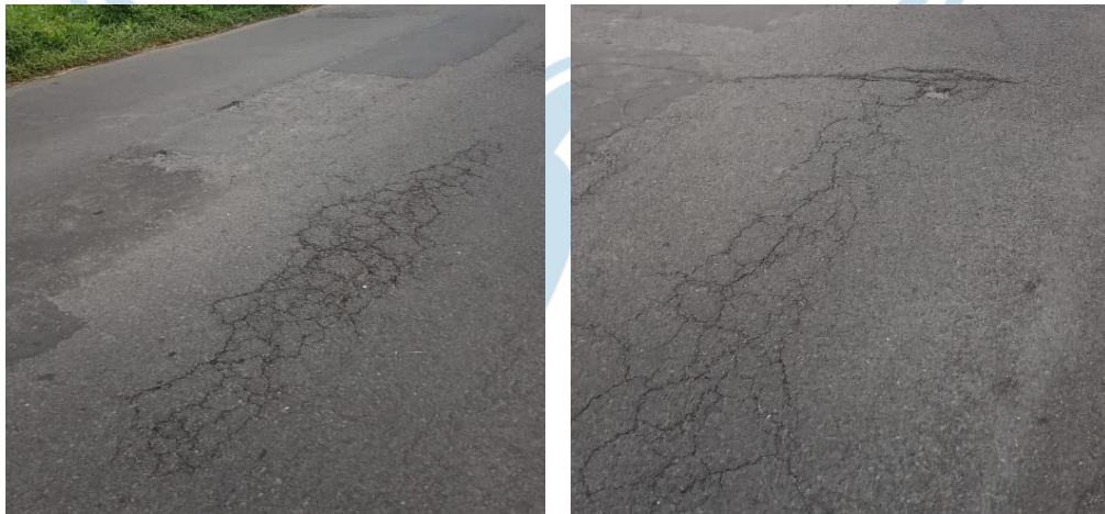
Gambar 1.1 Kerusakan Jalan Kalasan - Potrojayan (Sumber: dokumentasi pribadi)
