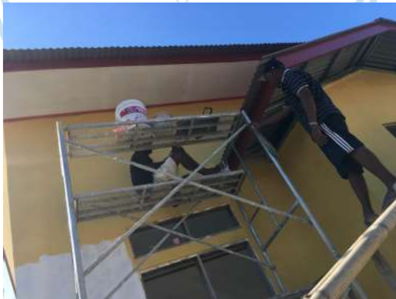
Pekerja Tidak Menggunakan APD saat Melakukan Pengecatan di atas Ketinggian.
