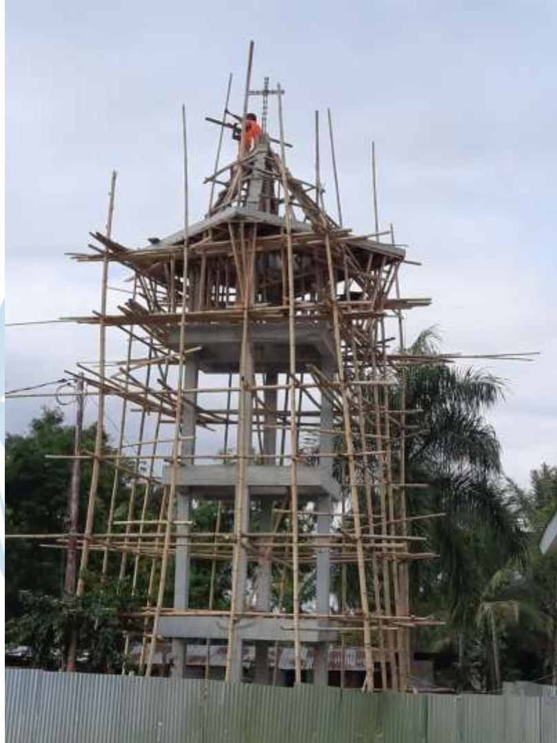
Pekerja Tidak Menggunakan APD saat Melakukan Pekerjaan di atas Ketinggian.
