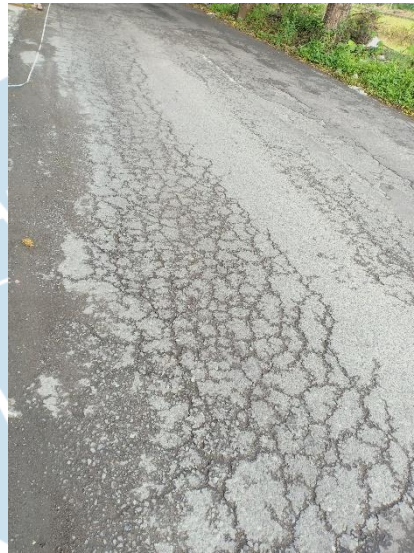
Gambar 1.1 Kondisi Permukaan Jalan Kapten Haryadi
