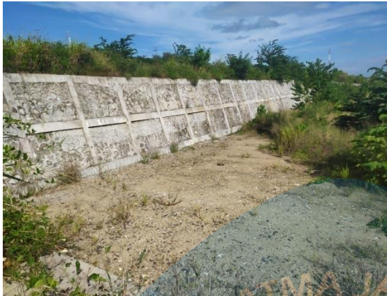
Gambar III.5. Talut pada Site (Sumber: Dokumentasi Pribadi, 2020)
