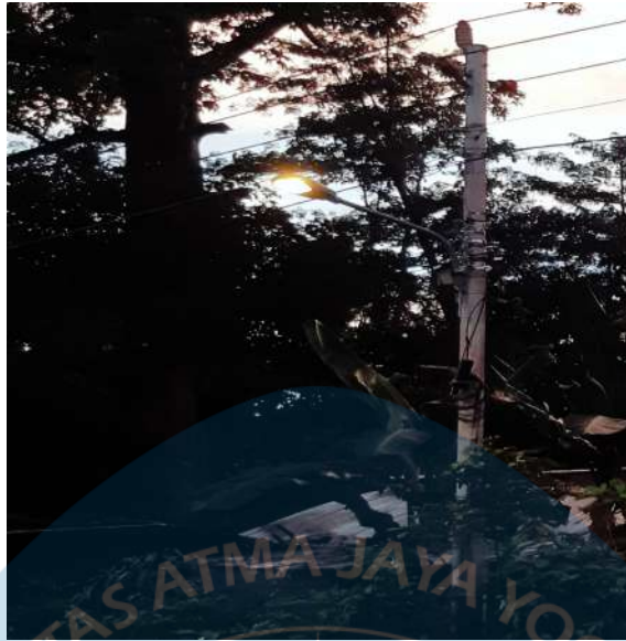
Kondisi penerangan pada jalan Kebun Raya
