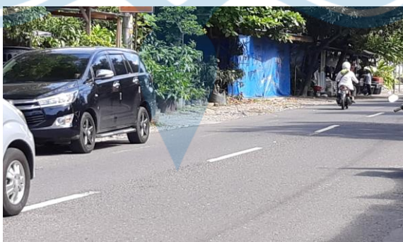
Gambar ppj 7 kondisi marka pada jalan Kebun Raya
