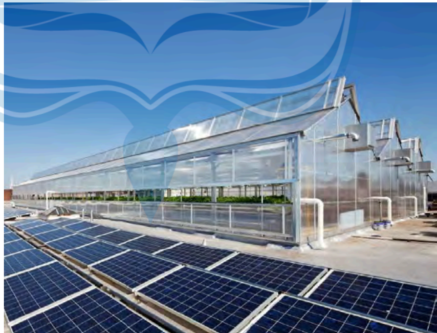
Gambar 2.29. Sistem Solar Panel Rumah Kaca Gotham Greens
