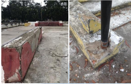
Gambar 3. 9 Kondisi Obstacle yang rusak
