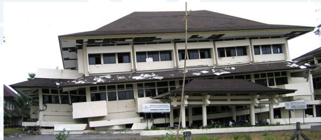
Gambar 1.2 Kerusakan pada ISI Yogyakarta akibat gempa jogja
