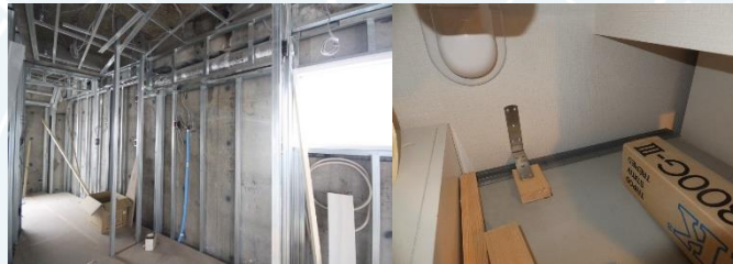
Gambar 2.14 Rangka baja ringan pada dinding beton bertulang
