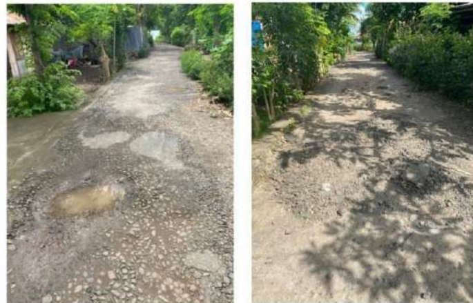
KONDISI JALAN LINGKUNGAN YANG RUSAK YANG MENIMBULKAN GENANGAN.
