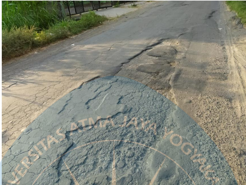
Gambar 1.3 Kondisi perkerasan Jalan LPM
