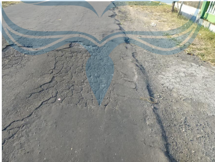
Gambar 1.2. Kondisi perkerasan Jalan LPMP
