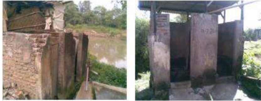
Gambar 1. 3 Kondisi MCK Umum pada permukiman kumuh yang di relokasi di Kelurahan Pucangsawit
