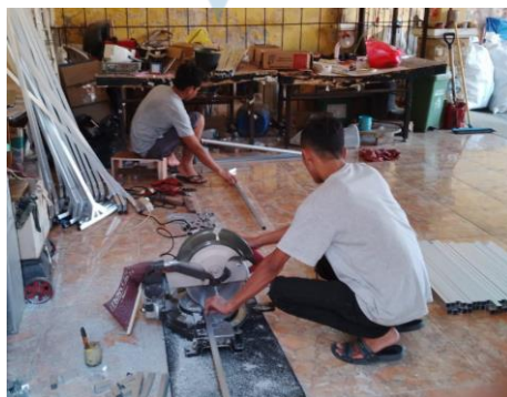
Gambar 1.3. Fasilitas Pekerja yang Terbatas
