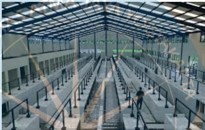
Gambar 6. 16 Struktur rangka ruang pada pasar Sumber: radarkudus.jawapos.com
