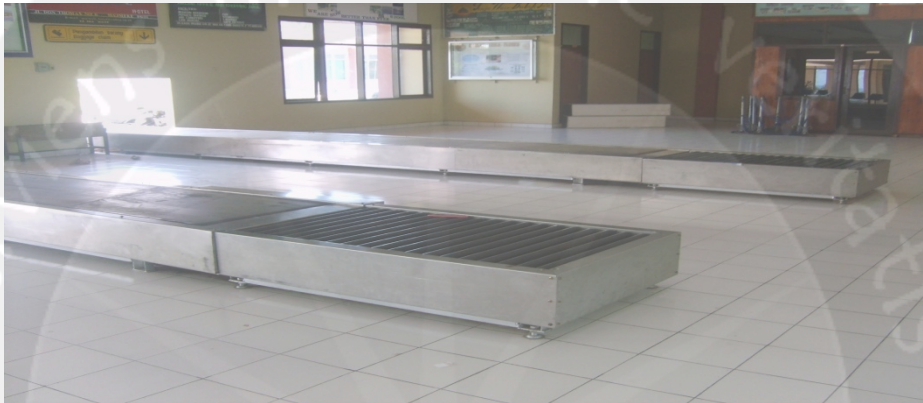
Gambar 2.6. Ruang Bagasi / Conveyor Bandar Udara Frans Seda Maumere
