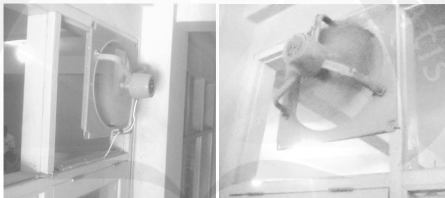
Gambar 6. Dua Exhaust Fan dipasang di sisi ruang. (foto: penulis)
