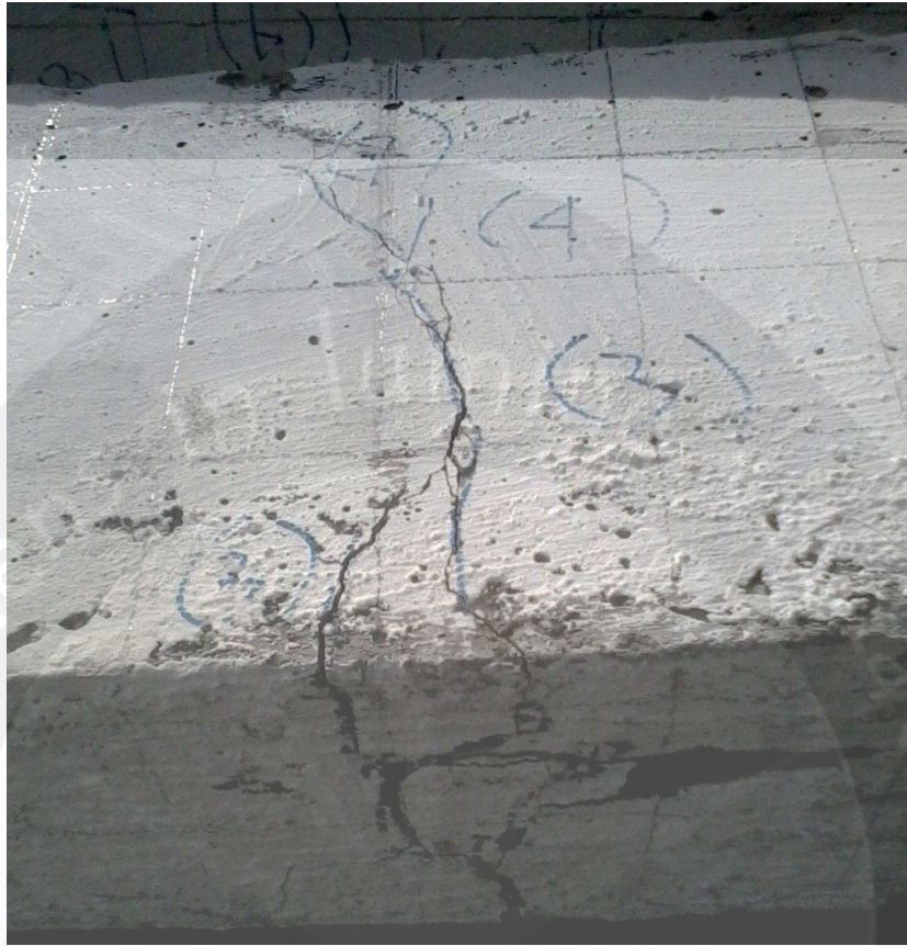
Gambar Retakan pada Balok setelah Pengujian
