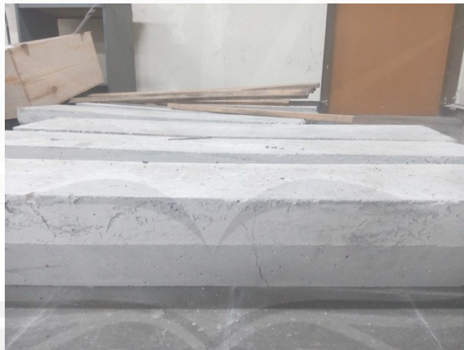
Gambar 5.4 Pola Retakan pada Pelat Beton Pracetak Berongga 3
